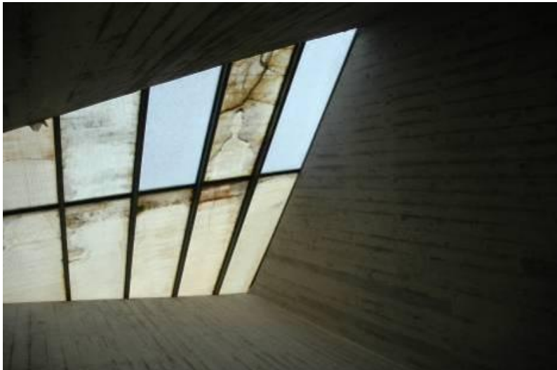
Verbrauchte Dachverglasung, z.T. blind – kein Sicherheitsglas
