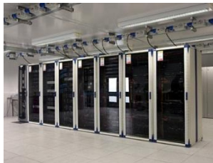
Server Kühlung ca. 25°C
