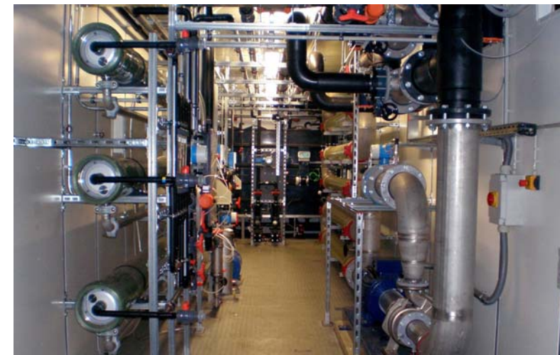
Ultrafiltration + RO, Wehrle
