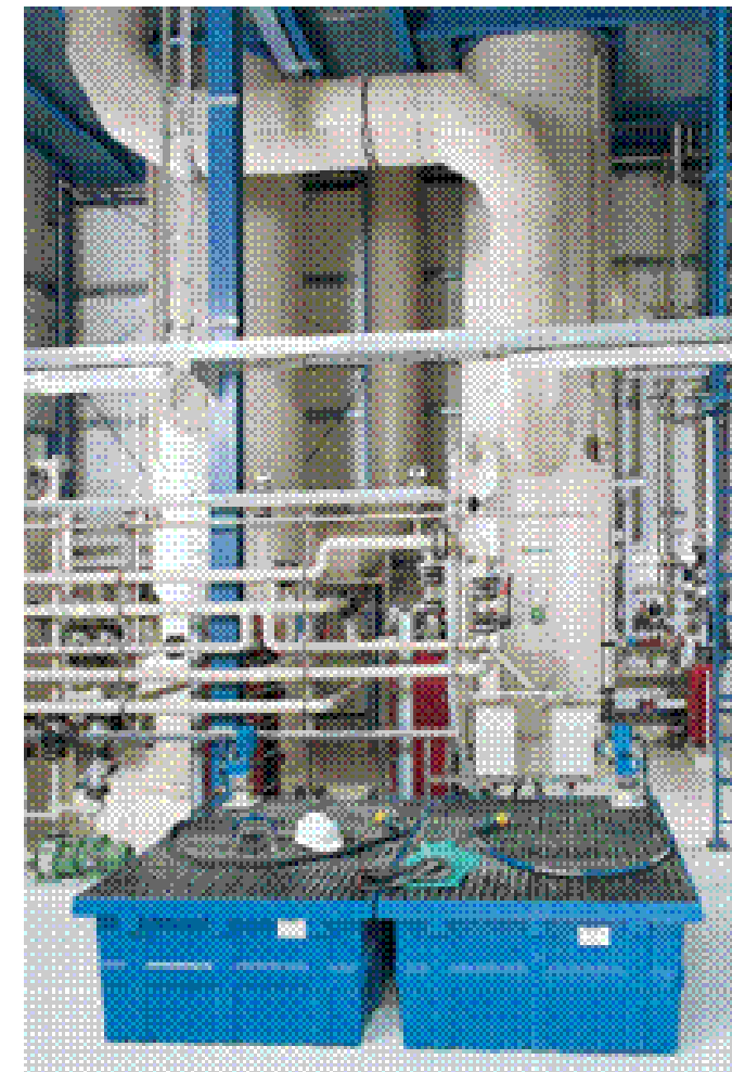
Luftstrippungsanlage, Fa. RVT
