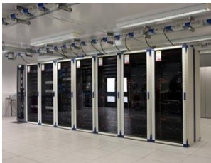
Server Kühlung ca. 25°C
