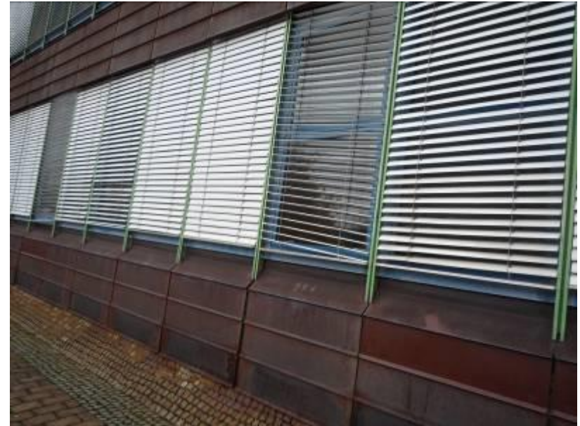
Verschlossener Sonnenschutz, Fassadenschäden
