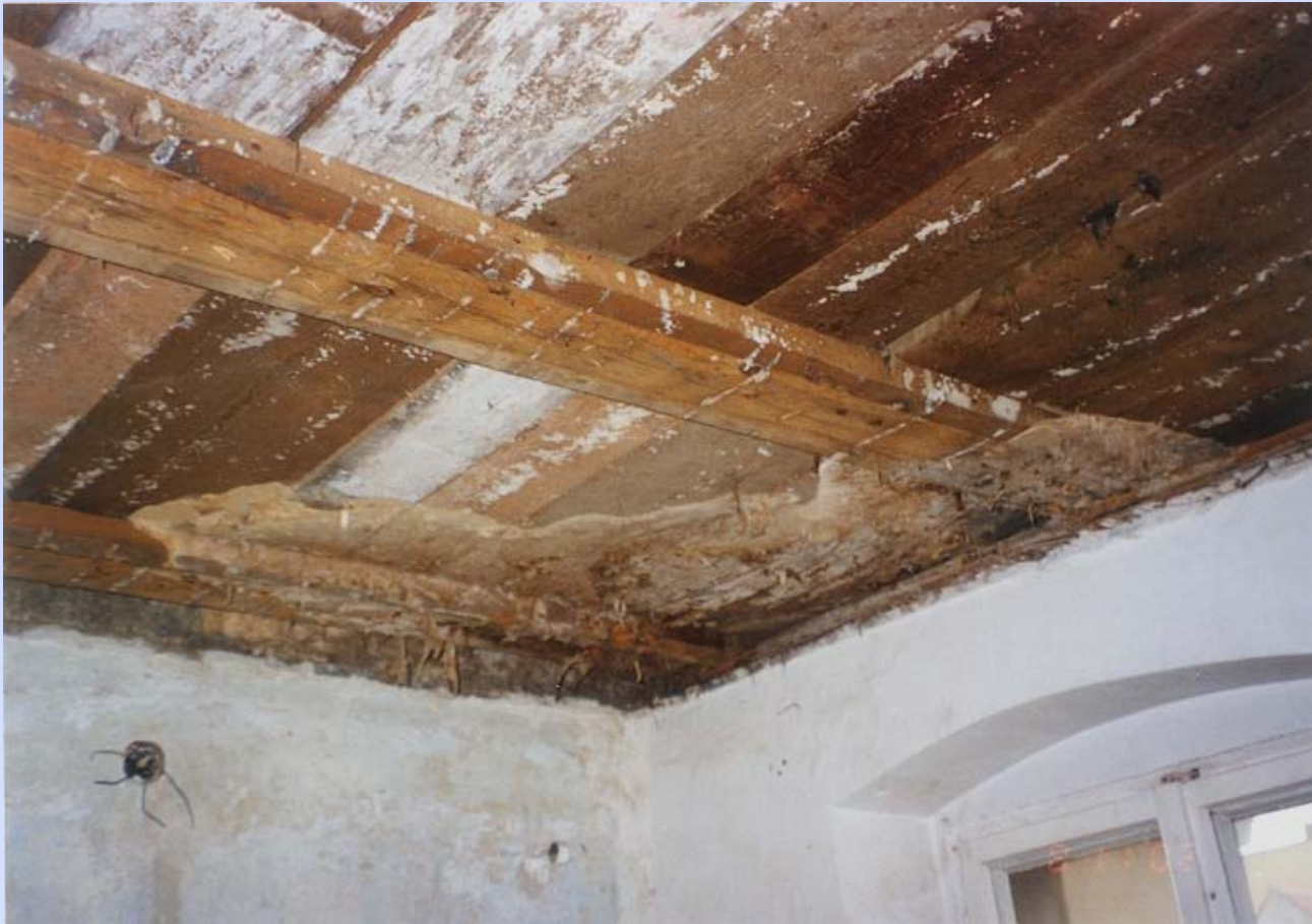
3. OG, Südzimmer: Befall durch echten Hausschwamm
