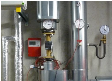
Präzise WMZ als Splitgerät aus Rechenwerk, Volumenstrommesser und Temperaturfühler im Bauzustand
