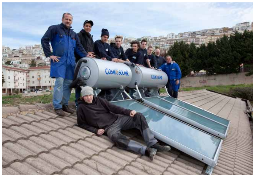
Eine solarthermische Anlage, hergestellt und installiert von Jugendlichen der Produktionsschule der Berufsbildenden Schulen Wilhelmshaven
