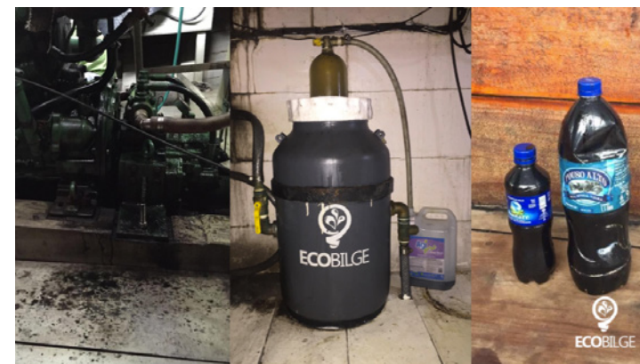
EcoBilge-Demonstration im praktischen Einsatz
